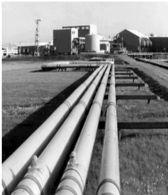
3. ábra. Föld feletti elhelyezett szén-dioxid szállító csővezeték
